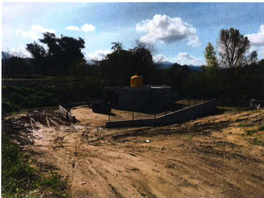
Poste de refoulement de Cavallu Mortu
